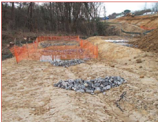
↑ Noue équipée de seuils en granulats concassés
